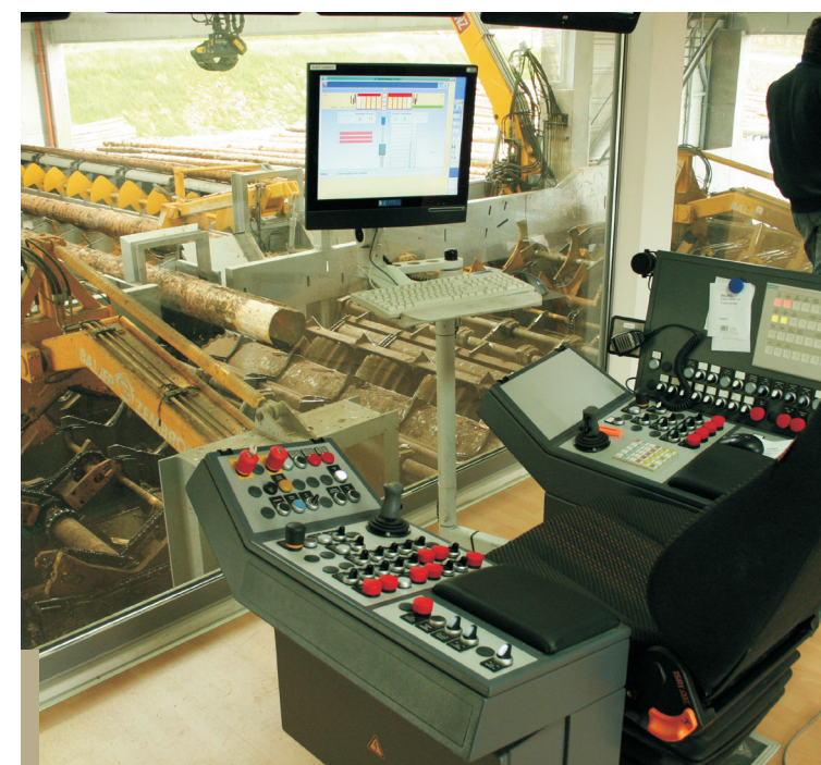
Sterownia tartaku zrealizowanego przez Holtec i Joerg.
